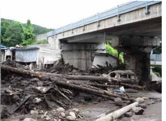
写真10 高速道路橋脚に掛かった瓦礫
