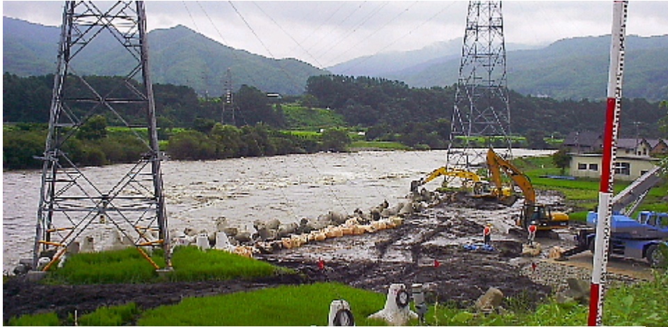
図4 決壊した堤防付近にテトラを敷き詰め鉄塔の土台を補強
