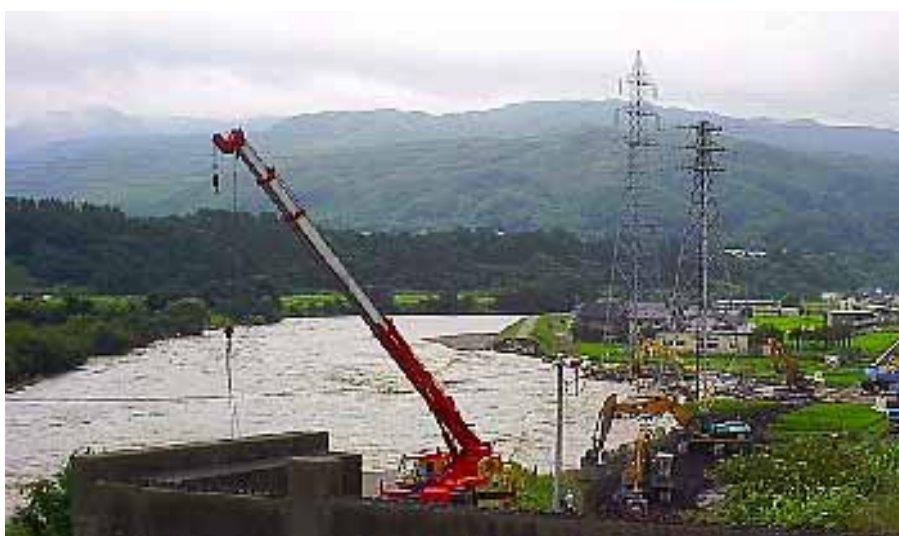
図2 大きく削り取られた堤防
