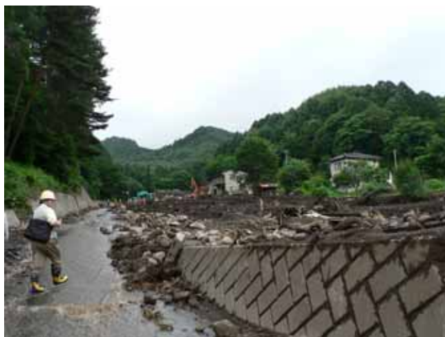
写真11 高速道路山側の土石流跡
