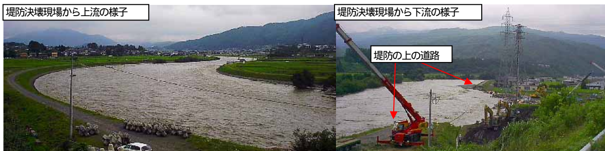
図1 箕輪町付近の天竜川堤防の決壊現場付近
